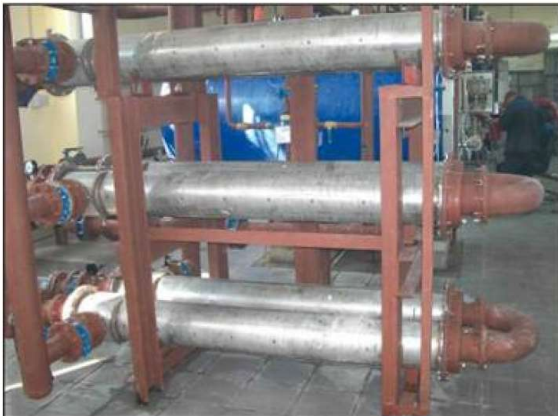
Рисунок 3.7 – Теплообменники ВВПИ в котельной МУП «Теплосервис»
